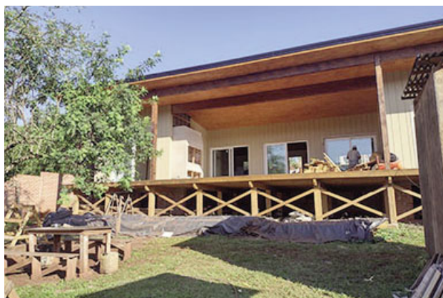
Vista del avance de obra de vivienda "llave en mano" que Rudolph construye en Eldorado, Misiones.
