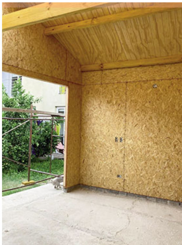
Un panel SIP soporta 15 toneladas en compresión.
