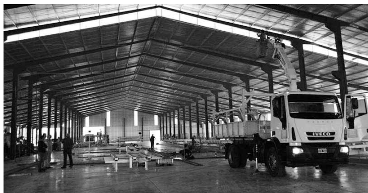
La obra instalada en el Parque Industrial Posadas representa una inversión de US$ 10 millones en infraestructura y en maquinaria alemana de última tecnología.
