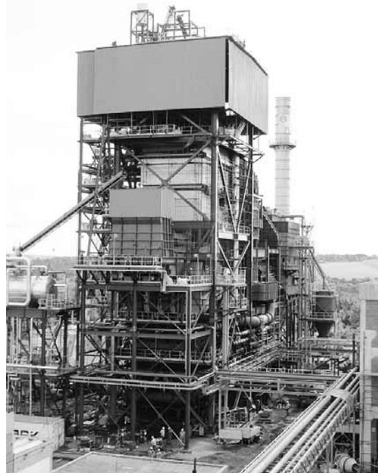
Caldera puesta en funcionamiento en 2013.
