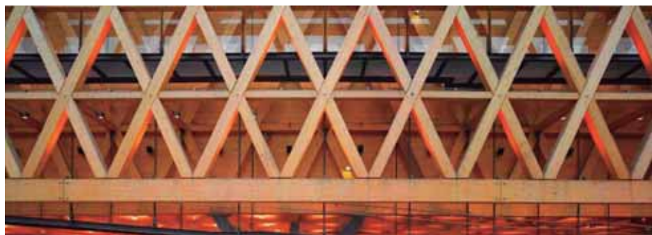
Parte de la estructura del Pabellón de Chile en la Feria de Milán, proyecto dirigido por el ingeniero calculista italiano
